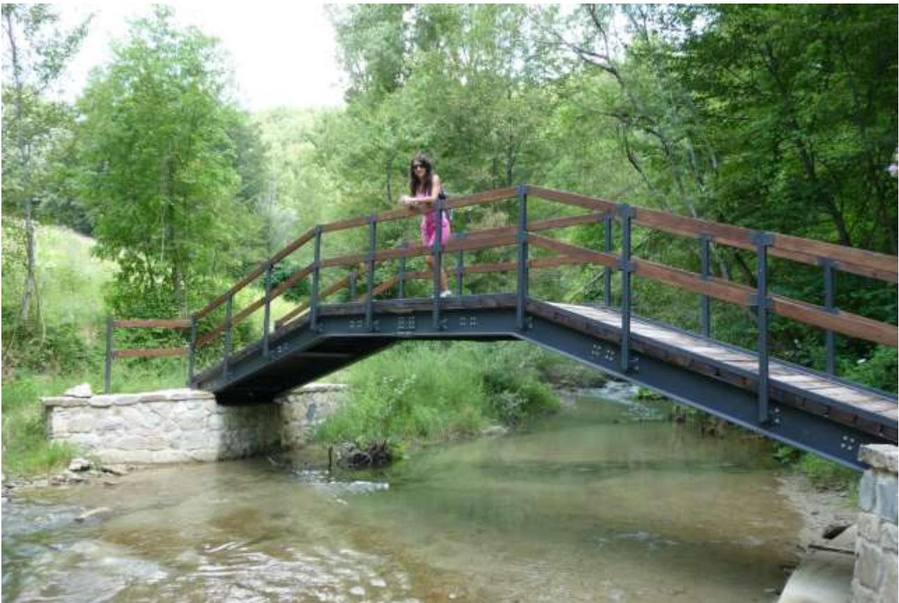
Uno delle passerelle pedonali esistenti lungo il sentiero del Tordino nella zona di Casanova (Cortino)
